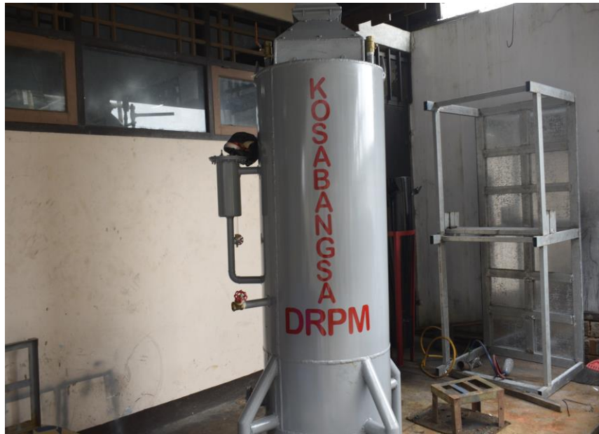
Gambar 7.20. TTG Boiler untuk proses produksi tahu bagi UKM Desa Kalisari
